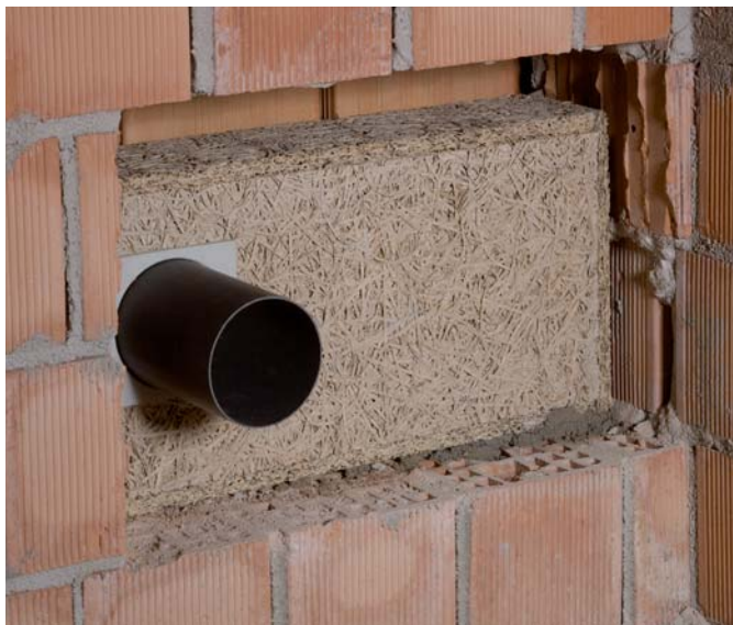
Posizionamento del Biosilenzio nella nicchia ricavata all'interno del muro perimetrale.
